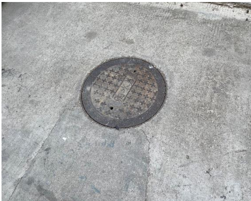
项目雨水井盖
