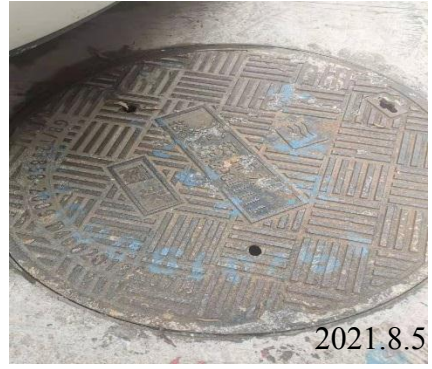
项目所在地雨水井盖
