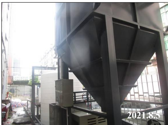
项目废水处理设施
