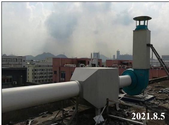
项目有机废气处理设施
