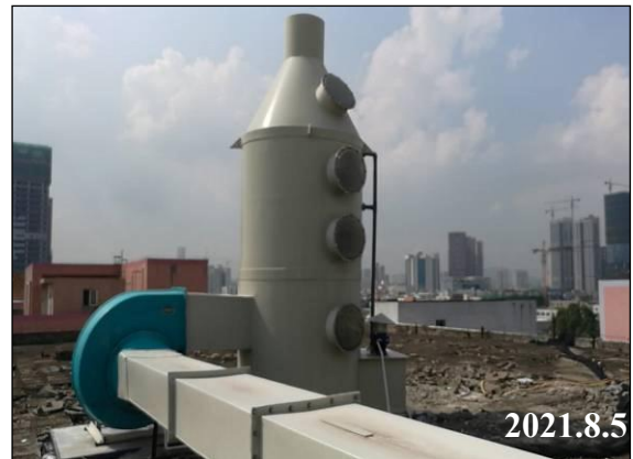
项目酸雾废气处理设施
